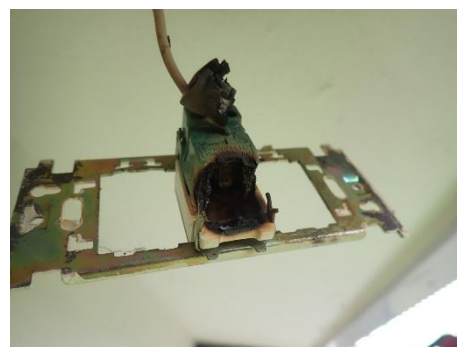
照明スイッチ焦げ跡
