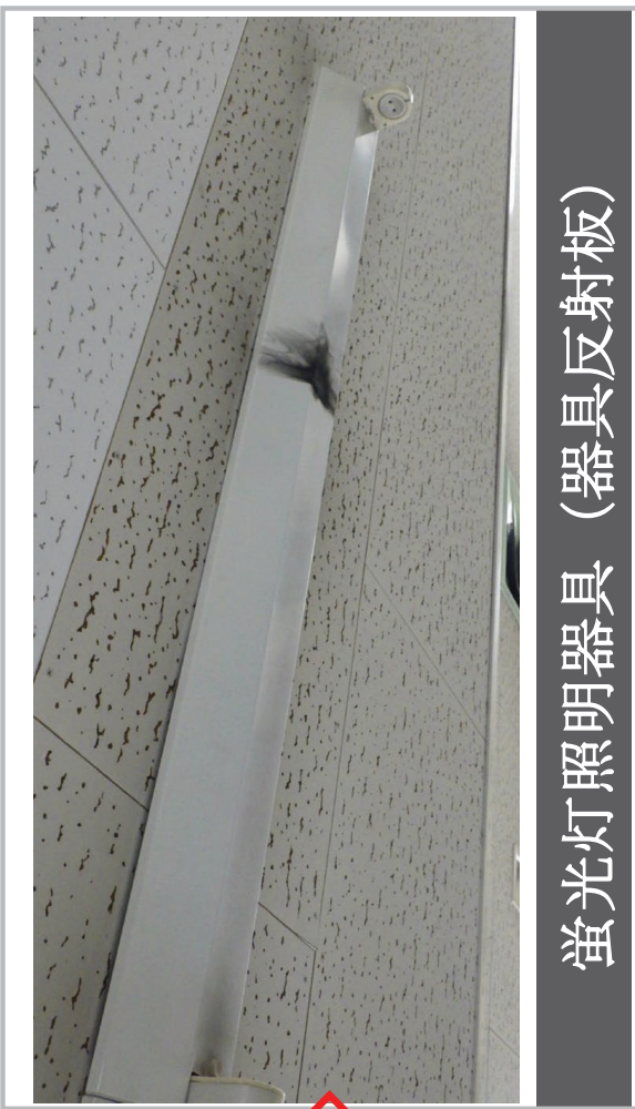
蛍光灯照明器具 (器具反射板) 開孔部周辺の表裏に煤が付着
