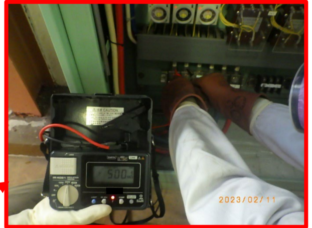
動力盤(排気ブロア電動機の系統)の絶縁抵抗の測定結果： > 500 \text{ M}\Omega
