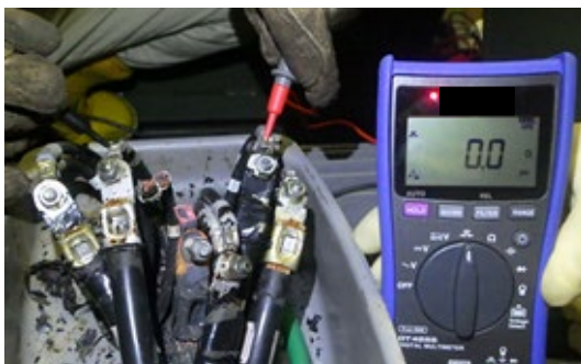
損傷のないケーブルの導通測定： 0.0 \Omega
