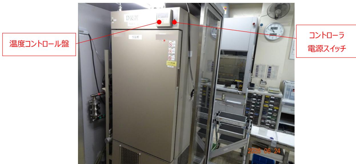
写真 2-1 発災した恒温槽の外観状況
