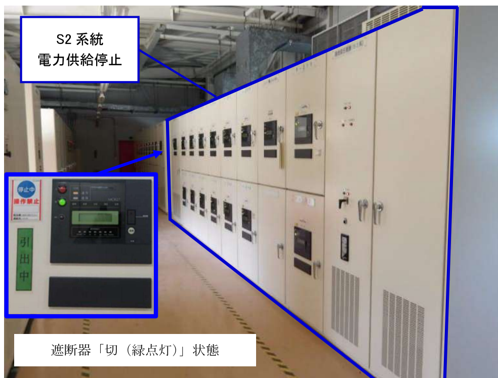
図 6 50GeV 変電所 発災直後の S2 系統電力供給停止状況
