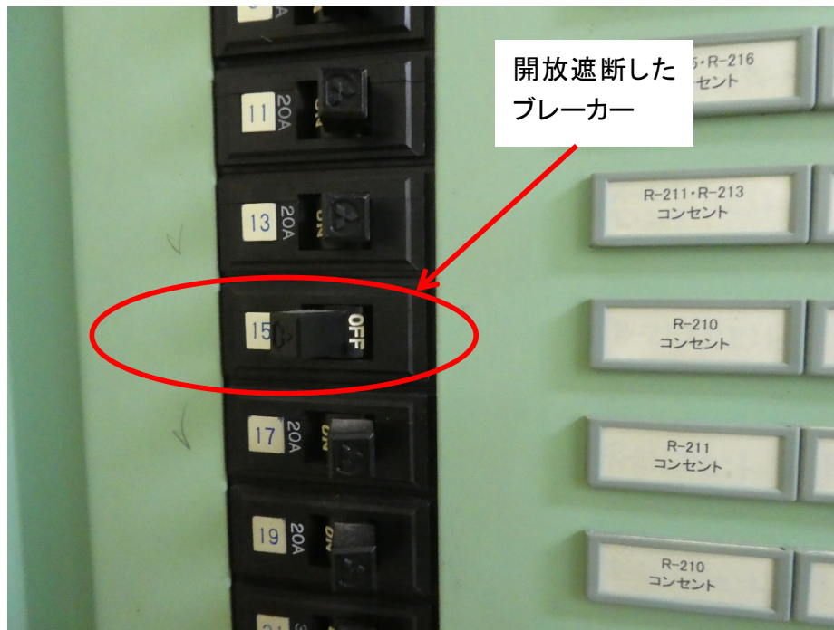
ブレーカーの開放遮断後
