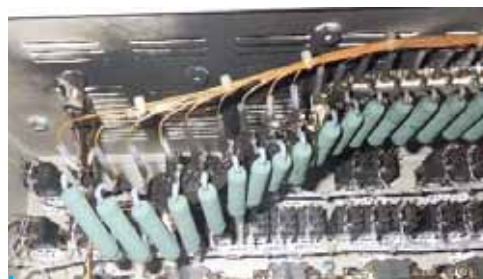
当該制御盤内
