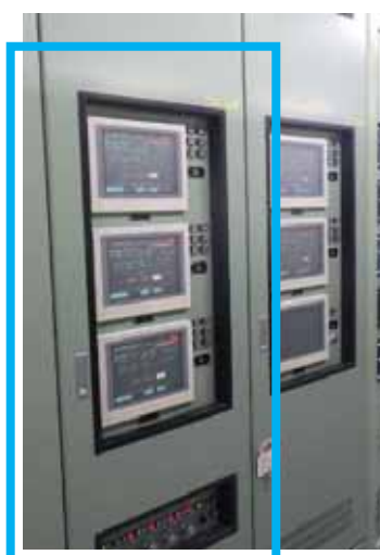
当該制御盤外観
