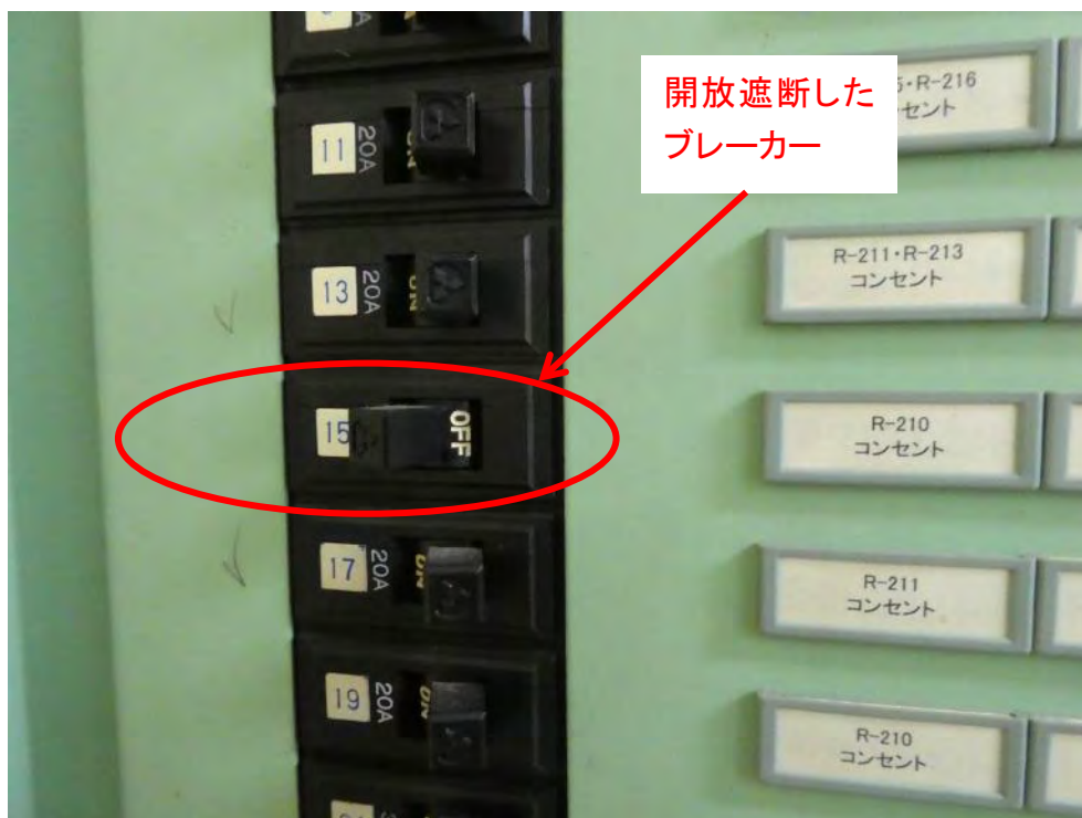
ブレーカーの開放遮断後
