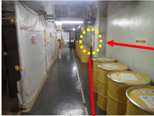
電源盤の周辺
