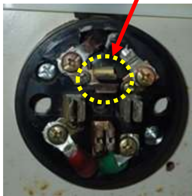
200V コンセントの内部
