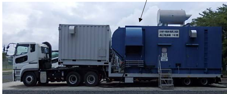
常設代替高圧電源装置
