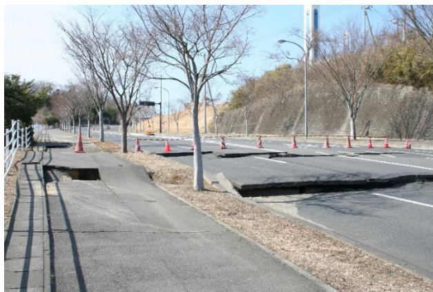
（↑東日本大震災直後の総合福祉センター「絆」付近の破断した村道）
