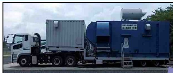
常設代替高圧電源装置 (高圧電源車) 常設代替 高圧電源装置置場の設置
