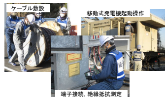
移動式発電機からの給電操作
