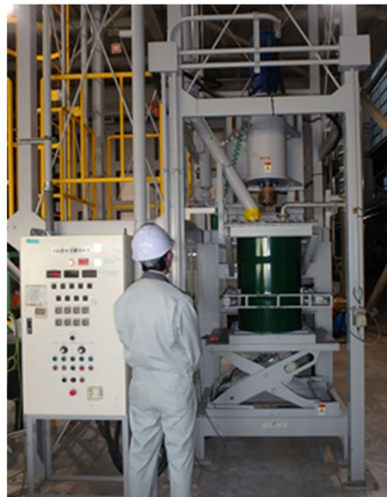
セメント固化設備の試験装置
