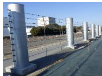
引き波用津波漂流物防護柵 設置完了後の外観(R5.1月完了)
