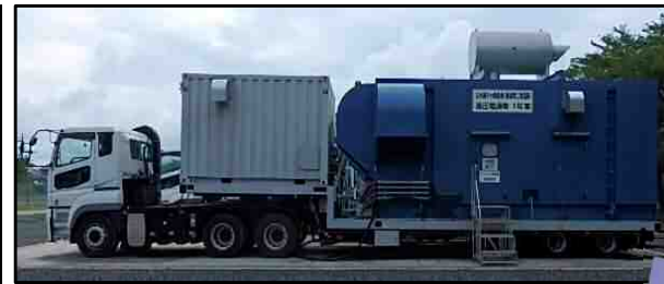
常設代替高圧電源装置 (高圧電源車)
