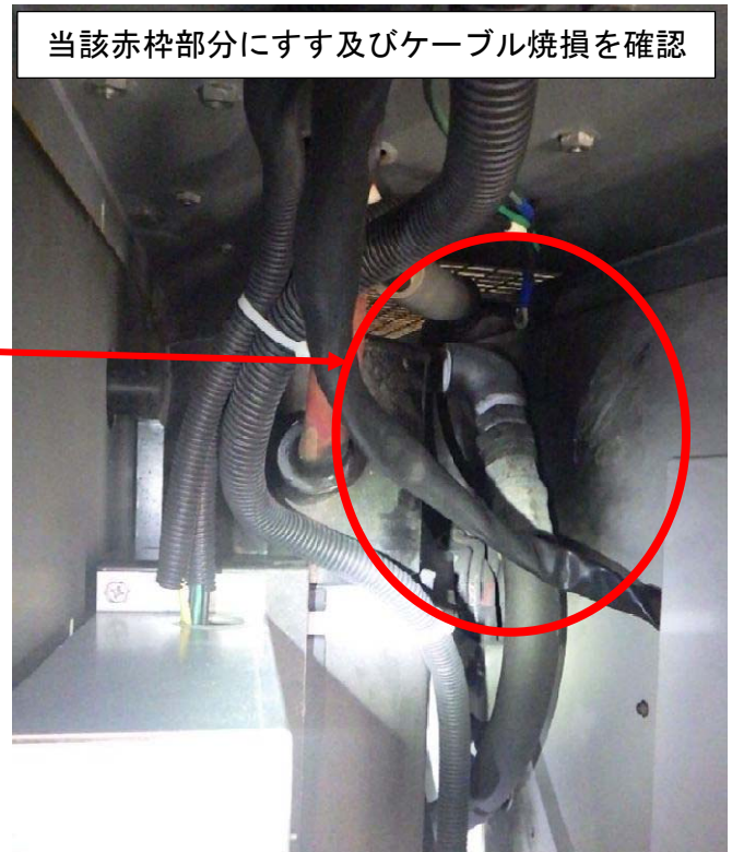
当該空気圧縮機内部（上部から見たところ）
