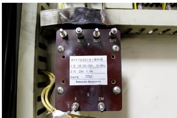
図 17 焦げ跡を確認した変圧器の状態
