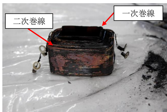
図 11 焦げ跡を確認した変圧器の分解状況（巻線全体）
