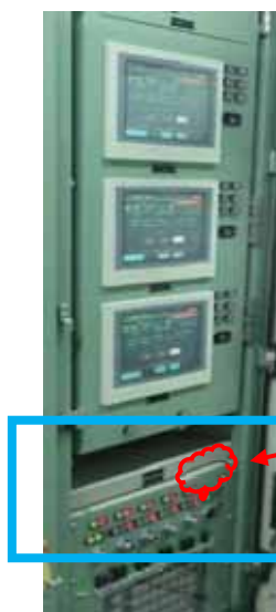
当該制御盤外観（外扉内）
