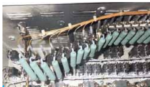
当該制御盤内
