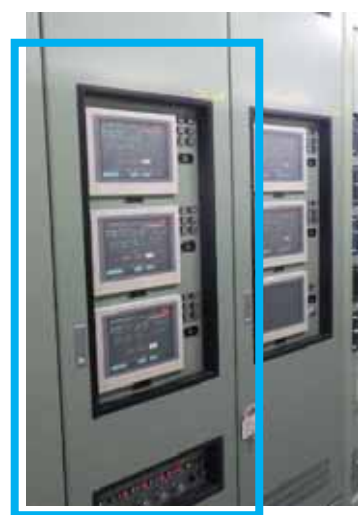
当該制御盤外観
