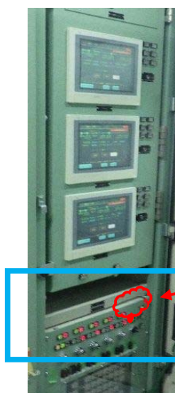
当該制御盤外観（外扉内）
