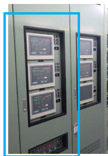
当該制御盤外観
