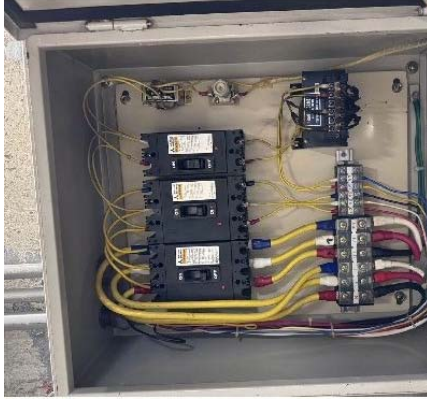
③当該空調機電源盤（空調機械室）
