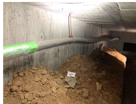
破断配管A全景
