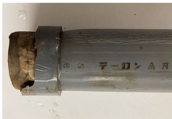
破断配管A 配管名称
