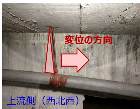
破断配管A 上流側吊り金具
