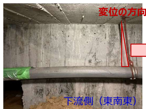
破断配管 A下流側吊り金具
