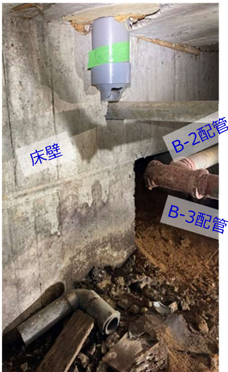
脱落配管B 脱落状況
