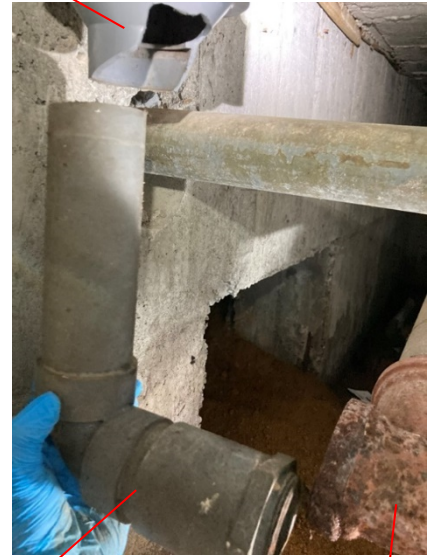
【脱落箇所B】
