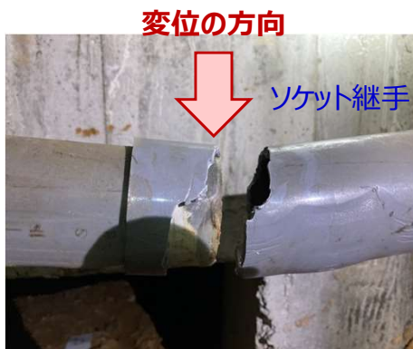
破断配管A 破断部
