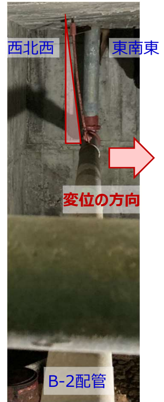
脱落配管B 上流側吊り金具部分
