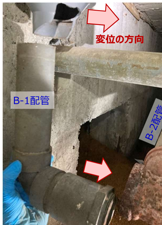
脱落配管B 脱落前状況（再現）
