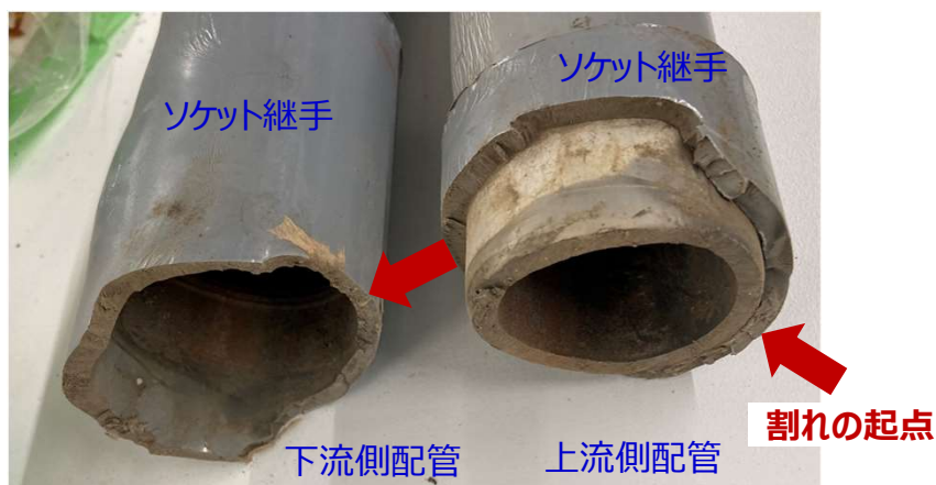
破断配管A ソケット破断面
