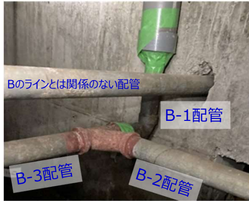
脱落配管B 脱落前状況 (現場写真)
