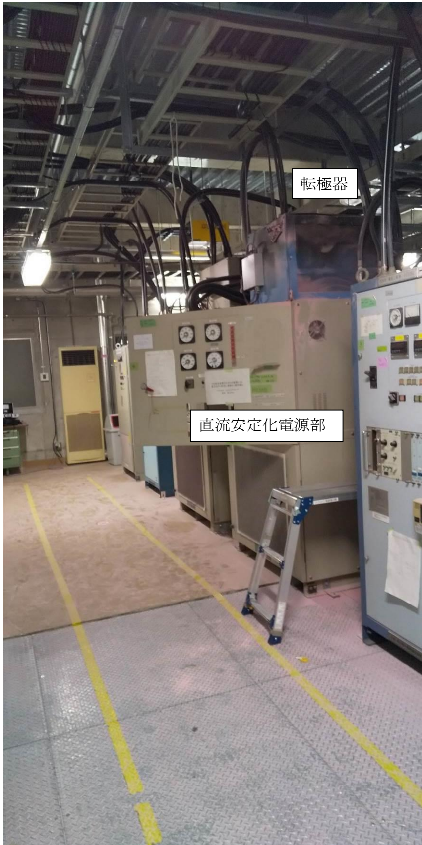
図4 当該電源装置の設置状況
