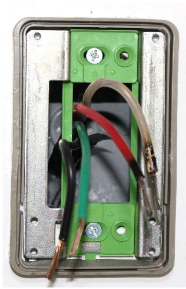
当該コンセント (配線被覆は高温により変色。ただし、内部の電線は異常なし)
