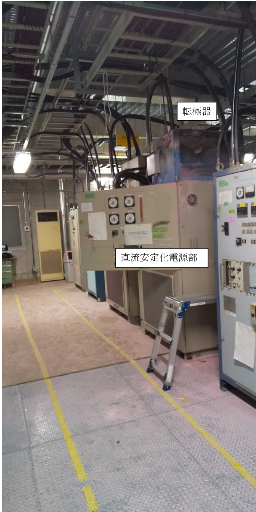
図4 当該電源装置の設置状況
