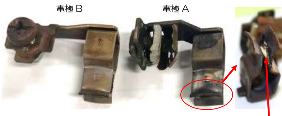
図 2-10 コンセント側の電極の状況
