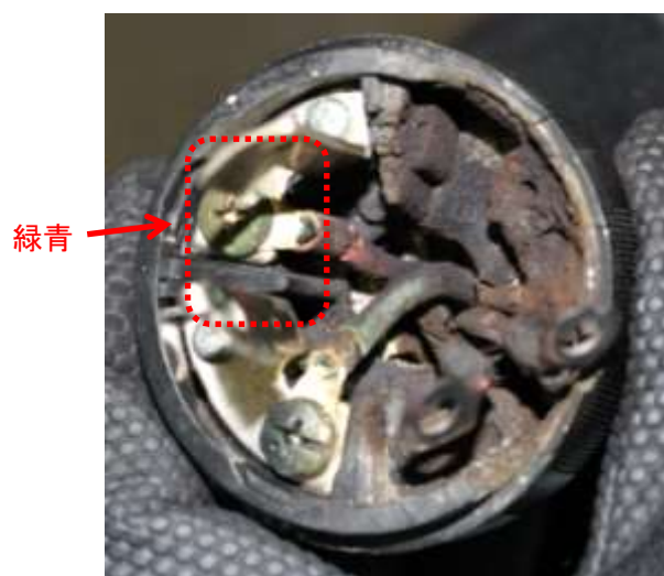
図 2-6 プラグ内部の緑青の状況
