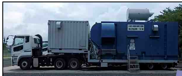
常設代替高圧電源装置 (高圧電源車)
