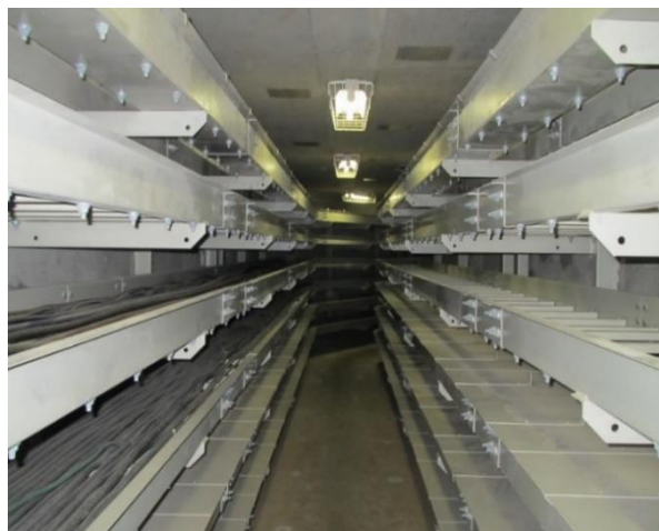
鋼材製ダクトによるケーブル分離
