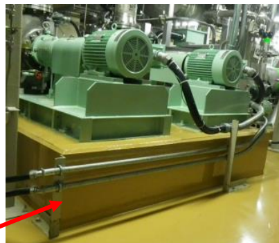
補助ポンプの基礎
