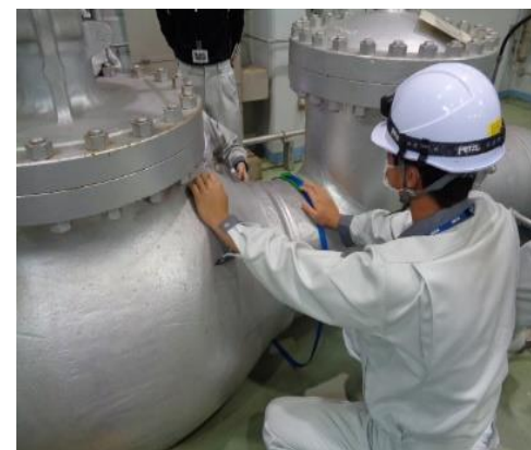
BDBA対応訓練の様子 (配管漏えい時の応急措置訓練)
