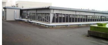
排水貯留ポンド
