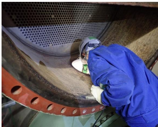
1次冷却材熱交換器の 開放点検の様子
