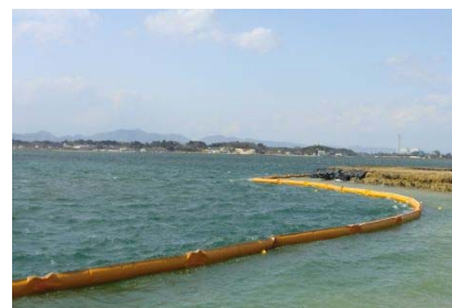
海洋への拡散抑制設備（汚濁防止膜）
