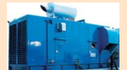
常設の高圧電源装置（設置予定）
