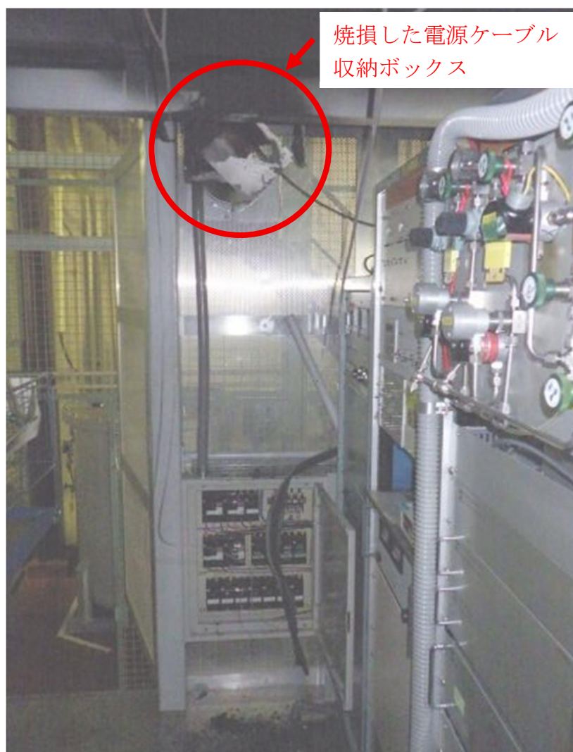
図4 焼損した電源ケーブル収納ボックスの周辺の状況（鎮火確認後に撮影）
