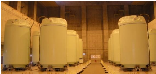
東海第二発電所の乾式貯蔵施設
