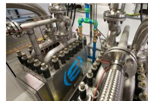
水素製造装置
