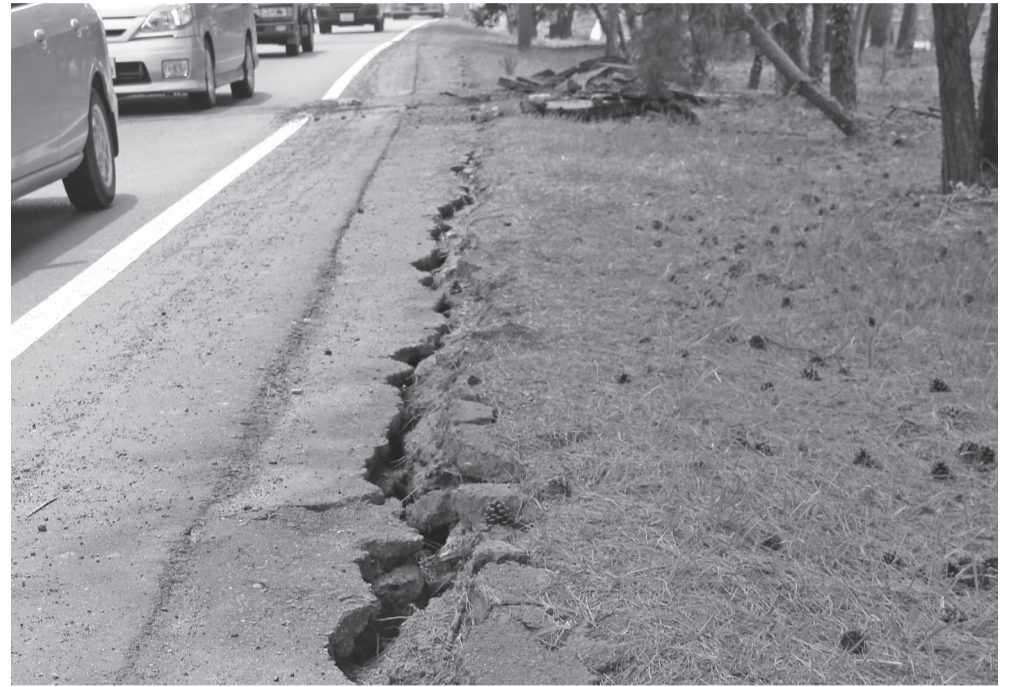
国道245号線西側歩道の亀裂
