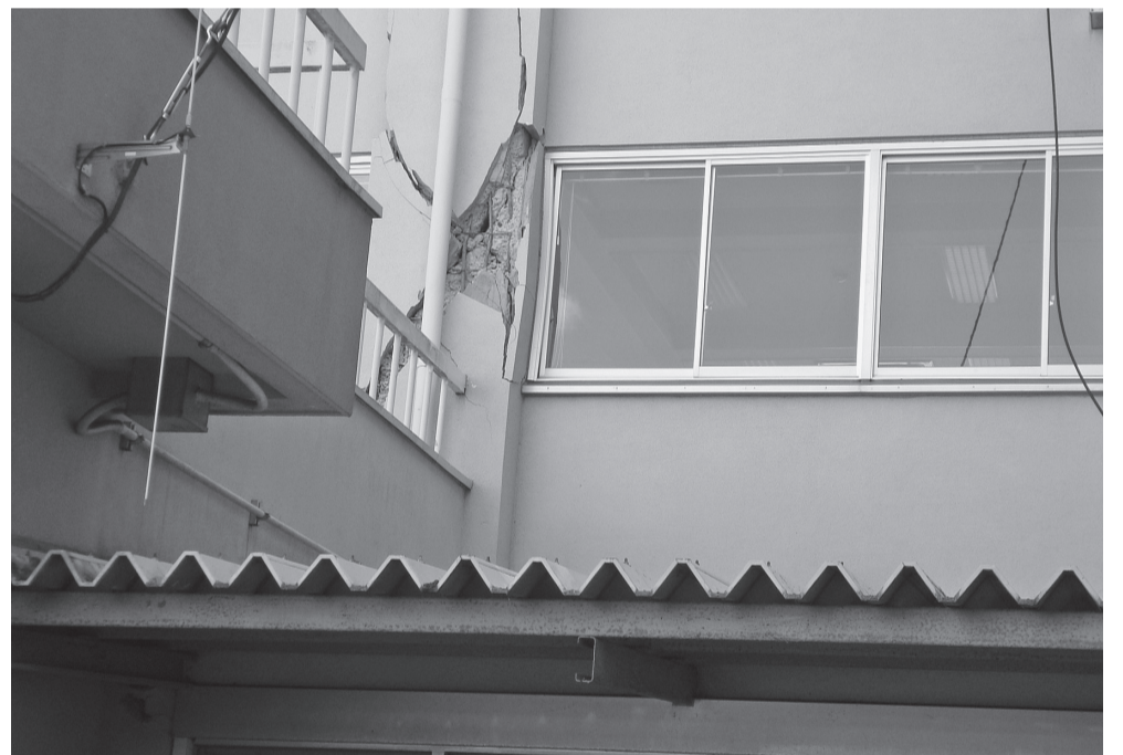
東海中本校舎の柱が大きく破損
