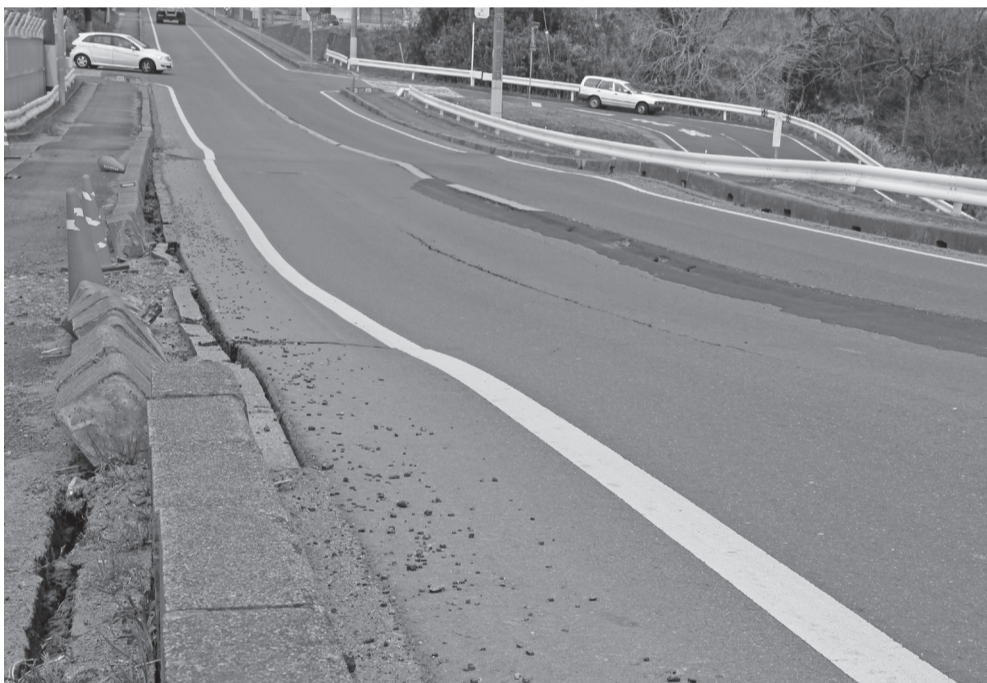
動燃駈上り線のゆがみと亀裂
