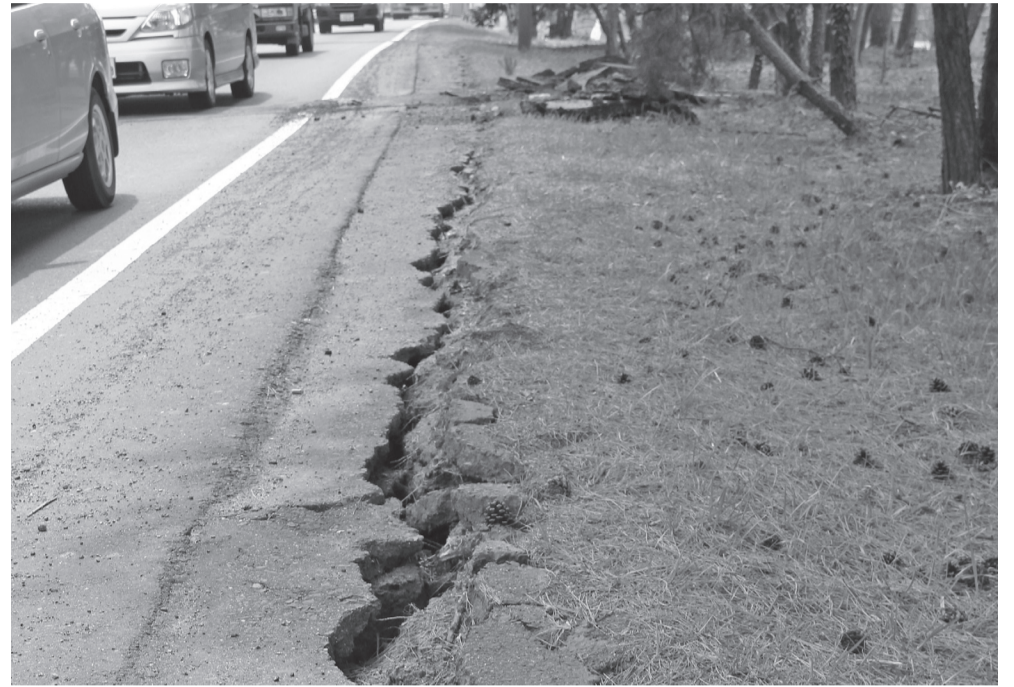
国道245号線西側歩道の亀裂
