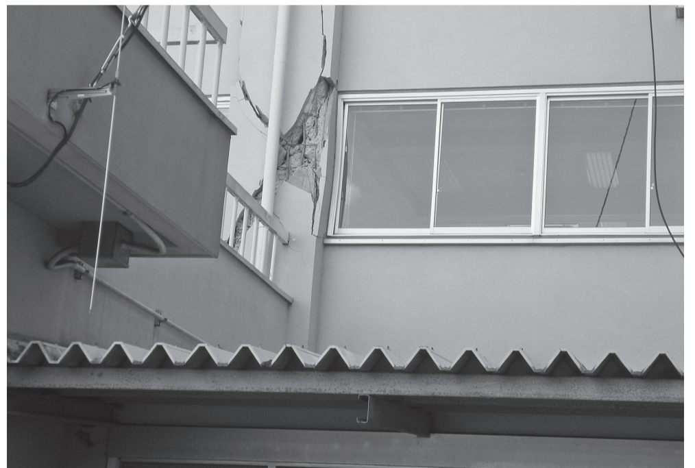
東海中本校舎の柱が大きく破損
