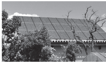
4KW太陽光発電システム
