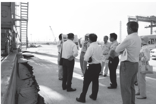
随所に陥没が見られる北埠頭
