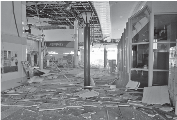
天井の落ちた東海駅自由通路
