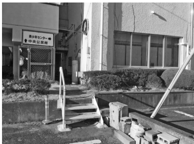
青少年センターの危険な出入口
