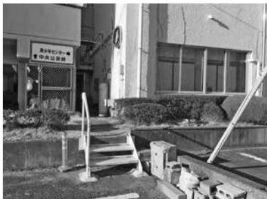
青少年センターの危険な出入口
