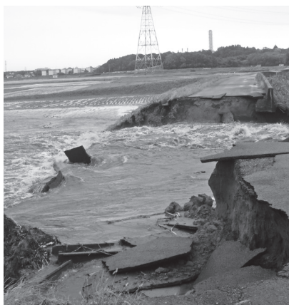
決壊した真崎浦の東新川堤防
