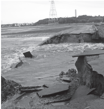
決壊した真崎浦の東新川堤防
