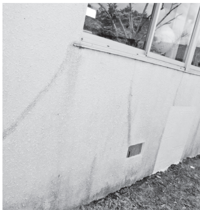
ひび割れが目立っている壁
