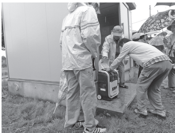
コミセン倉庫に配備した発電機の実践訓練
