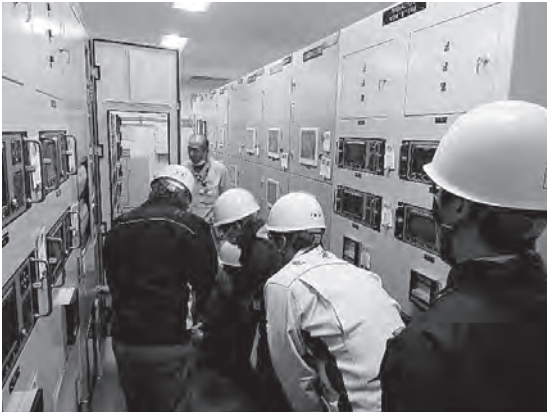
村と県が共に立ち入り調査を実施した 中央制御室の火災現場
