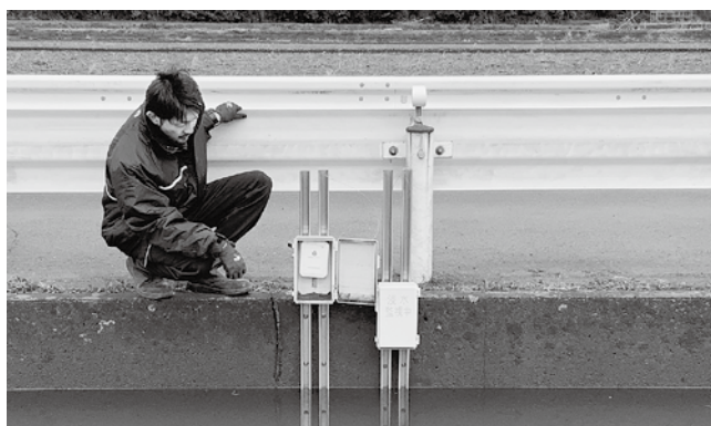
細浦・中央排水路に設置の浸水検知センサー
