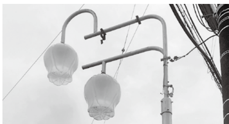
県道を照らす街路灯
