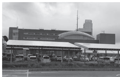
役場南側駐車場に設置されている太陽光発電システム
