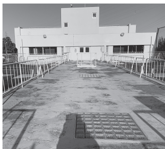
43年経った外宿浄水場の貯水槽のひび割れ
