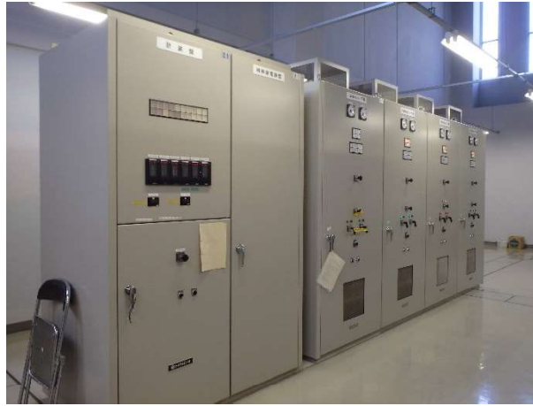
図 4.4 須和間配水場 電気盤
