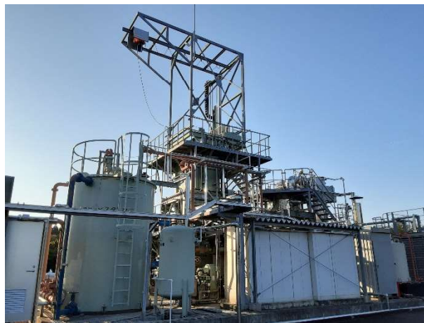
図 4.3 外宿浄水場 ろ過濃縮乾燥設備
