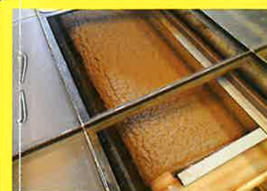
⑪〔汚泥脱水機〕 濃縮された汚泥に薬品（凝集剤）を加え、機械の力（ローラーによる圧搾）によって水分を取り除きます。
