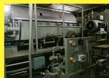
⑩〔遠心濃縮機〕 最終沈殿池で沈んだ汚泥は重力では濃縮しにくいので、遠心力で強制的に濃縮します。
