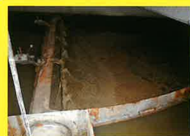
⑨〔汚泥濃縮槽〕 最初沈殿池で沈んだ汚泥はこの濃縮槽に運ばれ、時間をかけて重力により圧密し濃縮します。
