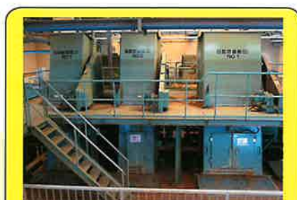
④〔沈砂池〕 流入下水中の大きなゴミや土砂を取り除きます。
