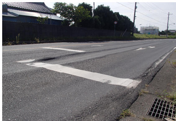
写真3：わだち掘れの状態
