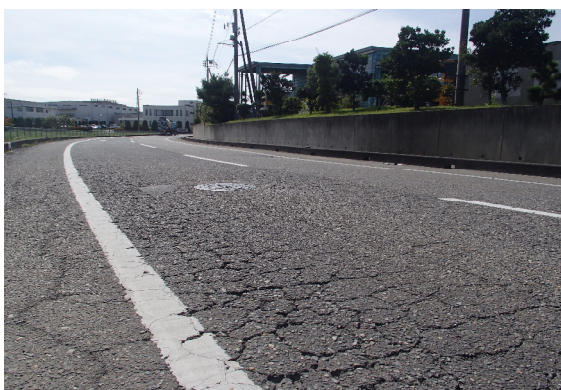
写真2：ひび割れの状態
