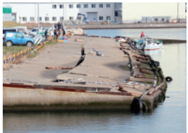
接岸できない埠頭：コンクリートが大きく割れ、接岸部分が沈み込んでしまった埠頭＝日立港第四埠頭付近
